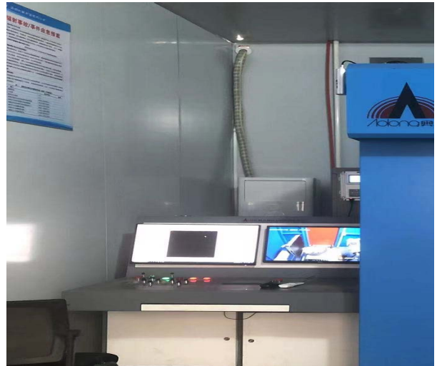
X射线检测室监控系统
